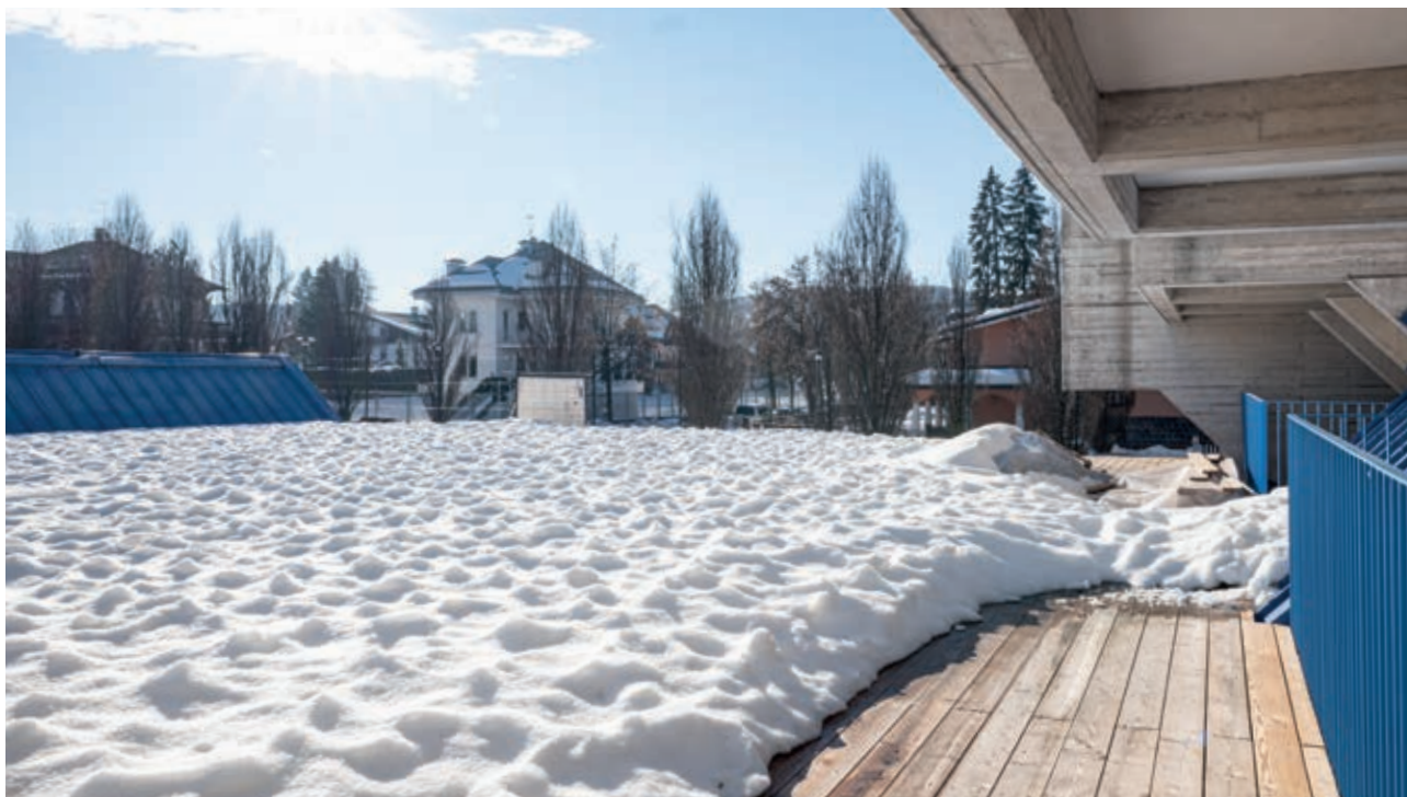
Istituto Comprensivo Statale – Rooftop, terrazze Asiago (VI), Italia Woodeck System – New Maxi NM
